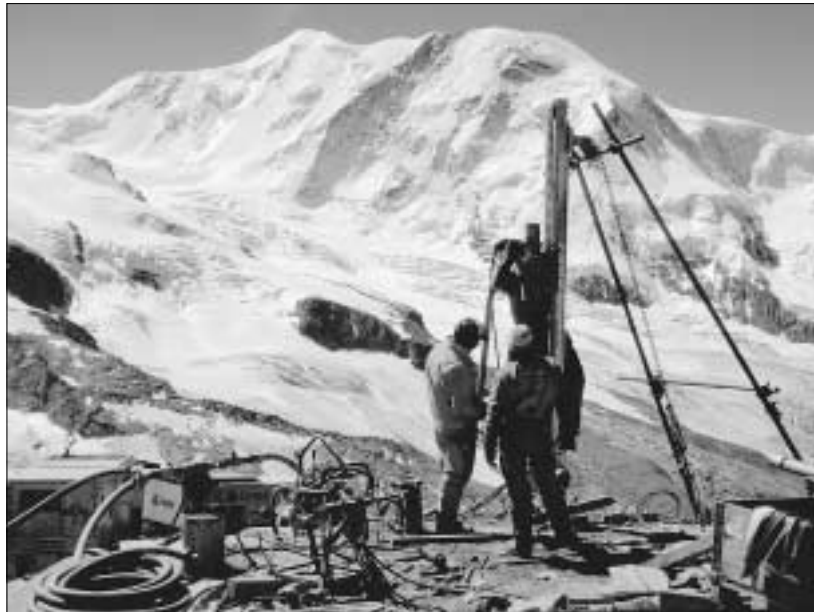
Auf dem Stockhorn (3410 m ü.M.) werden Bohrarbeiten für Langfristmessungen im Permafrost des Monte-Rosa-Gebietes bei Zermatt durchgeführt. Im Hintergrund der Lyskamm (4527 m ü.M.) mit seinen angefrorenen Hängegletschern. (Bild zVg)
